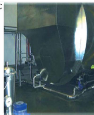
Ilustración 3: La imagen de la derecha muestra la posición de la cámara térmica. El punto de medición Sp1 tiene una temperatura de 23,2 °C; el punto de medición Sp2, de 28,3 °C; y el punto de medición Sp3, de 26,9 °C.
